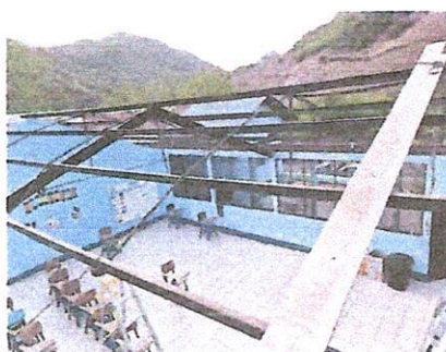
Foto 2: Sustrucción de lámina en área de aulas
